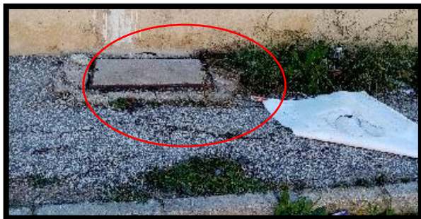
Figure n° 138 : très mauvaise état de trottoir. Source : l'étudiante,2020.
