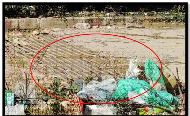
Figure n°147 : fossé bouché avec des déchets à voie tertiaire Source : l'étudiante
