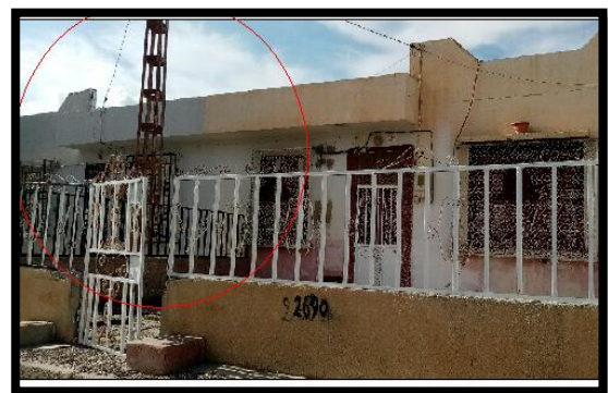
Figure n°149 : poteau d'une basse tension à l'intérieur de la maison Source : l'étudiante,2020.
