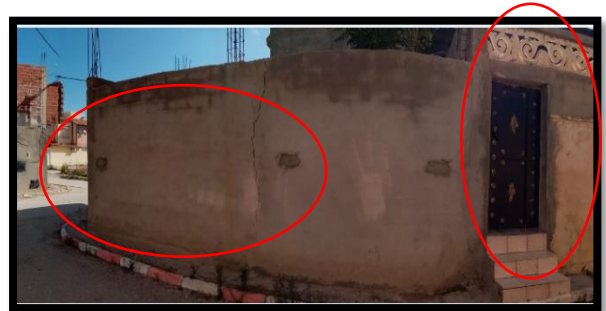
Figure n°156 : Exemples des façades déformées de logement et trottoir violé illégalement. Source : L'étudiante,2019.
