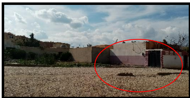
Figure n° 132 : très mauvaise état de trottoir. Source : l'étudiante,2020.
