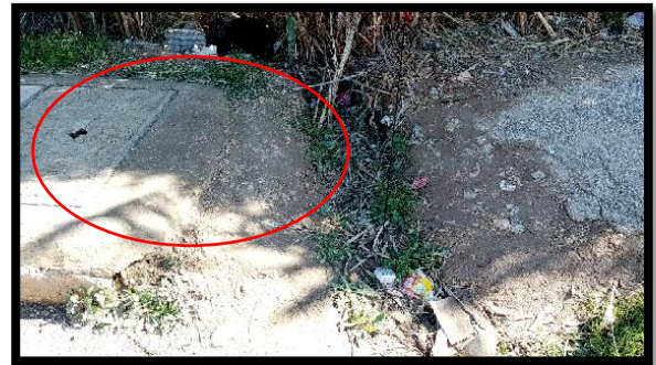
Figure n°145 : avaloir bouché sur un trottoir de la voie primaire. Source : l'étudiante .2019.
