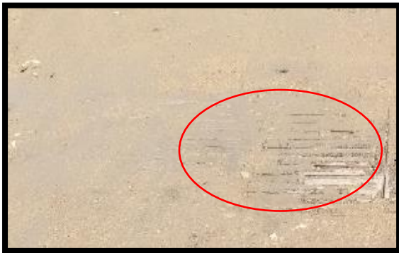
Figure n°144 : avaloir bouché de la voie primaire qui se traduit par des inondations en cas de pluie Source : l'étudiante ,2019.
