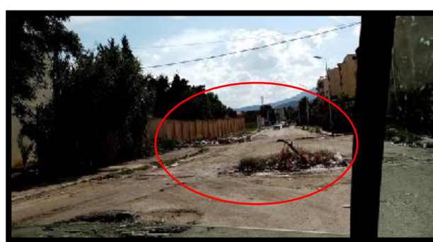
Figure n° 137 : Très mauvaise état de la voirie primaire. Source : l'étudiante,2020.
