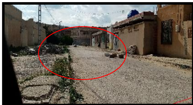
Figure n°134 : un état dégradé de quelque voirie. Source : l'étudiante,2020.
