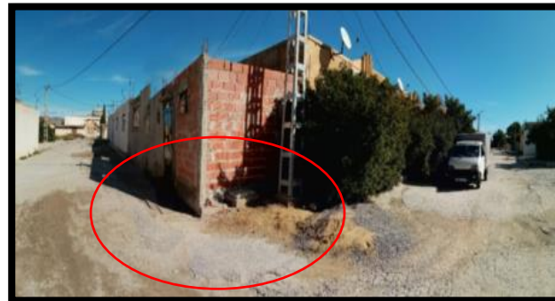
Figure n°135 : Absence totale des trottoirs à cause des modifications. Source : l'étudiante,2020.
