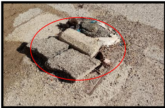
Figure n°146 : fossé bouché avec des déchets à la voie tertiaire Source : l'étudiante
