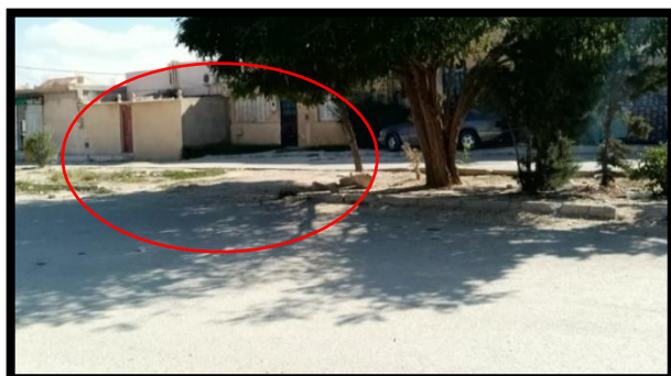
Figure n° 136 : mauvaise état de trottoir. Source : l'étudiante,2020.
