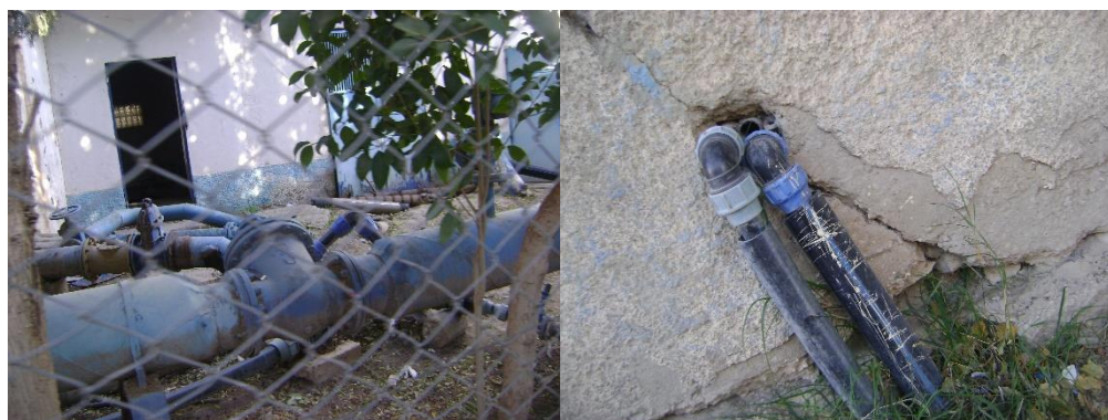
Image 18 : Station de pompage
