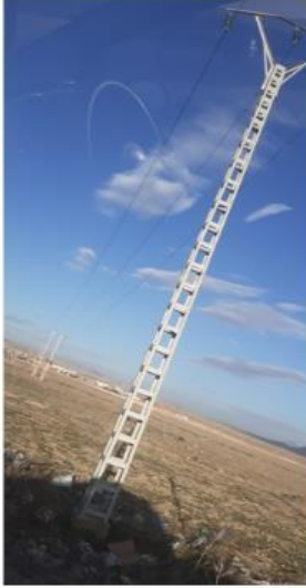
الشكل رقم 114: تصوير شخصي لخط الكهرباء
