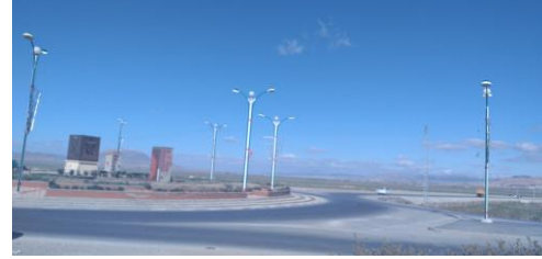
الشكل رقم 115: تصوير شخصي لخط الكهرباء
