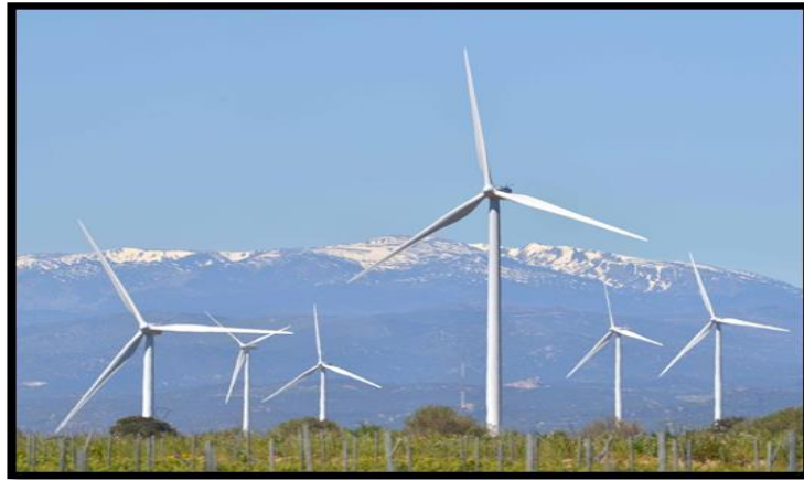
Figure 17 : Parc d'éolienne, Source : Chauveau, 2016.
