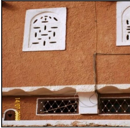
Photo4 : Protection des ouv et texture rugueuse
