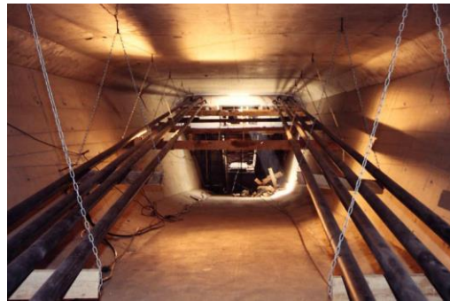
Fig. 1.10. Câbles de continuité extérieurs
