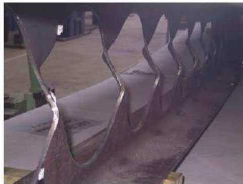
Figure 1.9 : Ruine par flambement du montant d'âme sous cisaillement [18]
