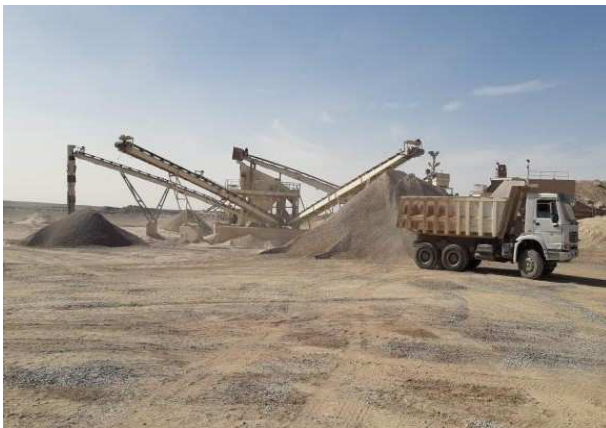
Photo III.1: Vue d'une installation de concassage-criblage
