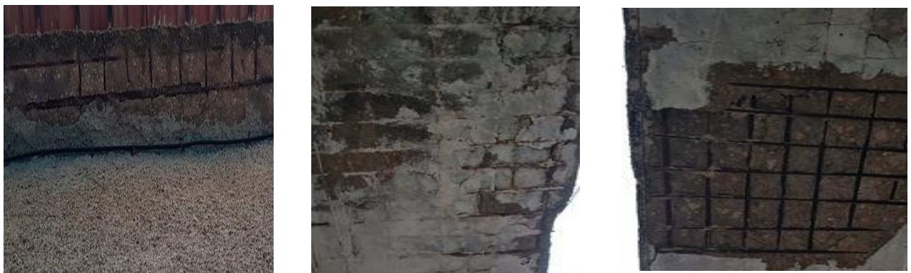
Figure 1.3. Exemples de la conséquence de la corrosion.
