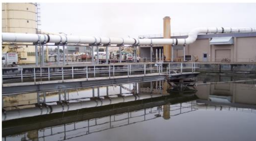
Figure VI. 4. Épuration des eaux
