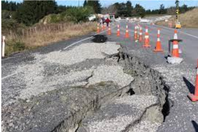
Figure 1. 5 Rupture rotationnel avec fissuration
