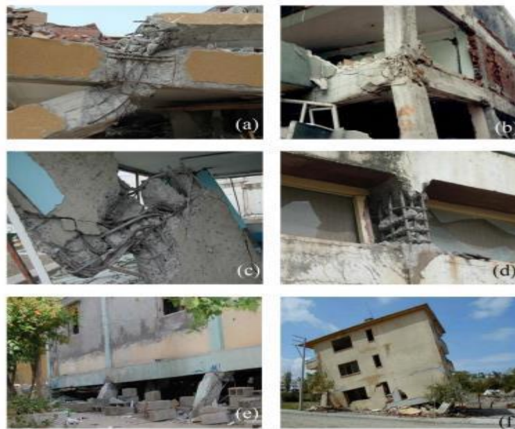
Figure 1.5 : Dommages subis par les portiques.
