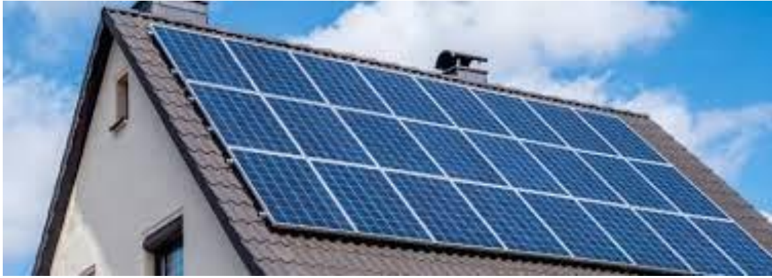
Fig.1.2. Energie solaire photovoltaïque.
