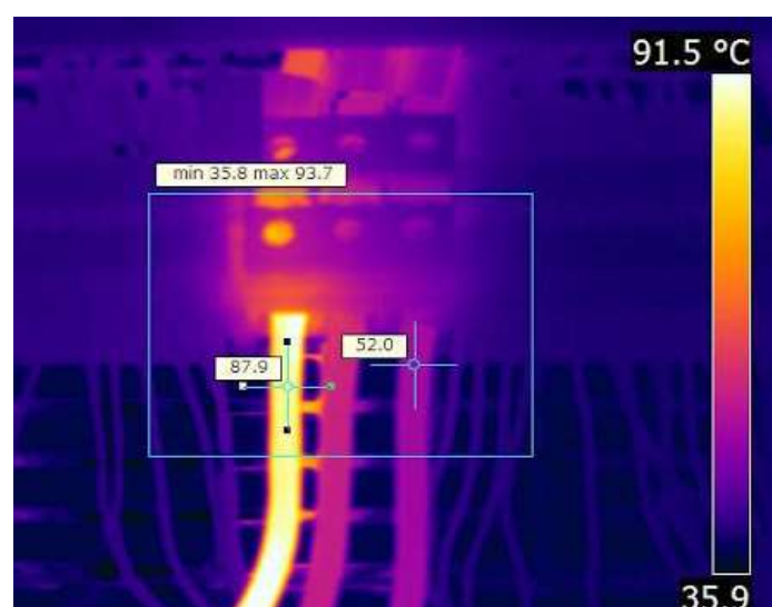
Figure I-4 : Principe de l'analyse thermographique : Visualisation d'un défaut de connexion sur l'image thermique.
