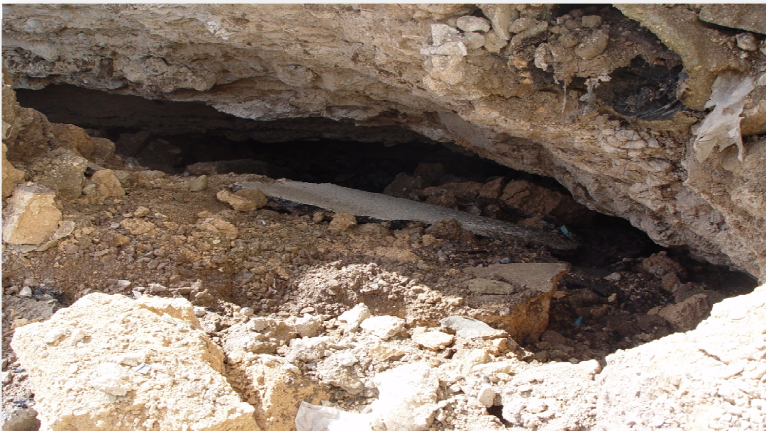
Fig. 56 : Photo montrant la proximité à la surface de la voute de la cavité effondrée.
