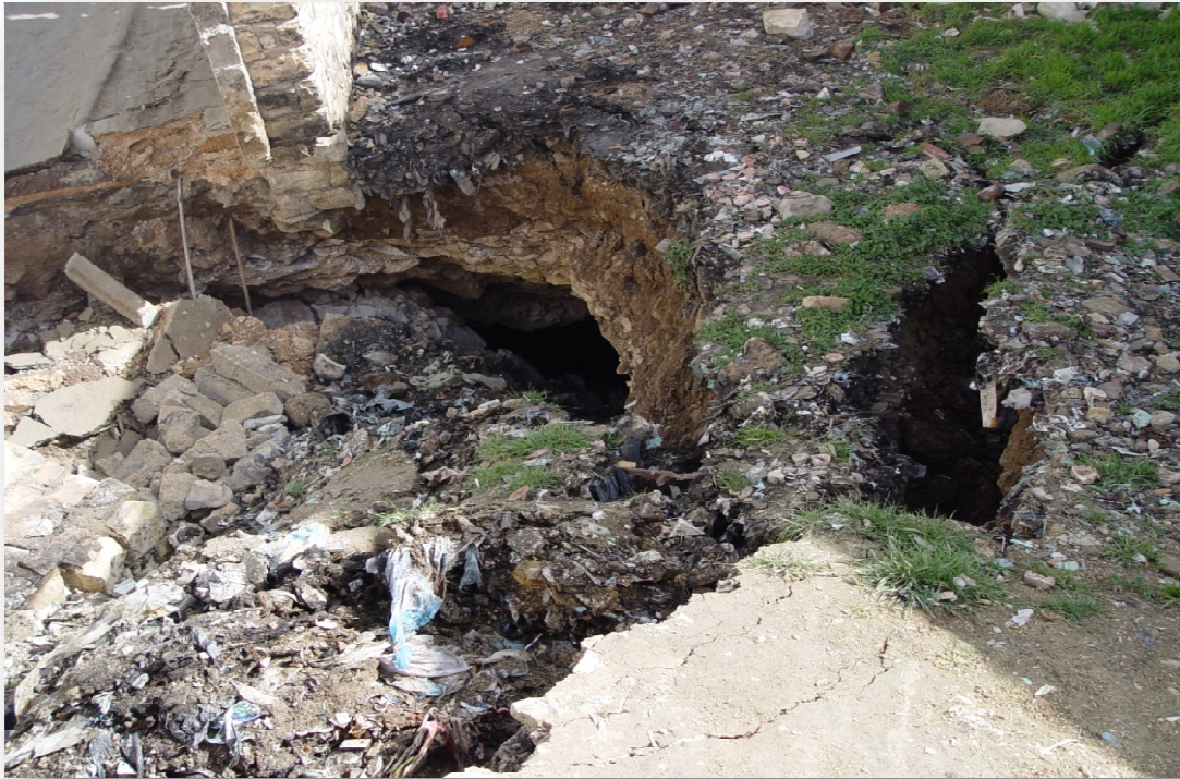
Fig. 57: Décharge des ordures au dessus de la zone effondrée.
