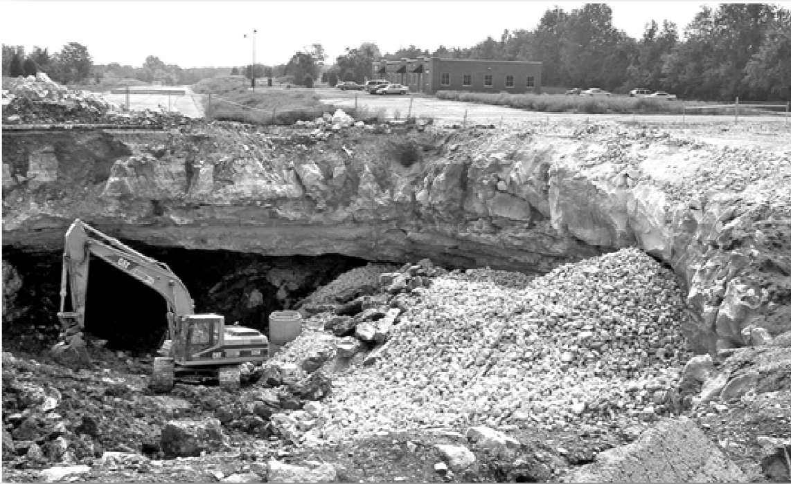
Fig. 81 : Roche fracturée autour de la marge d'une nouvelle doline d'effondrement qui a détruit la route de Dishman Lane à Bowling Green, à Kentucky, en 2002.
