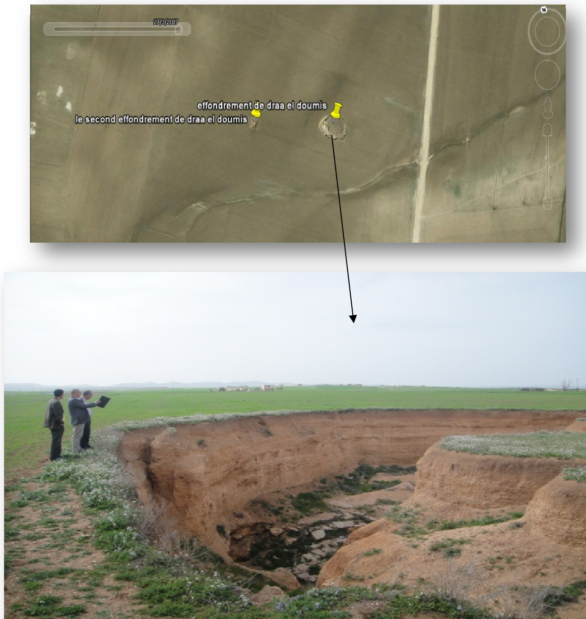
Fig. 53 : photographies de l’affaissement de Draa Douamis.
