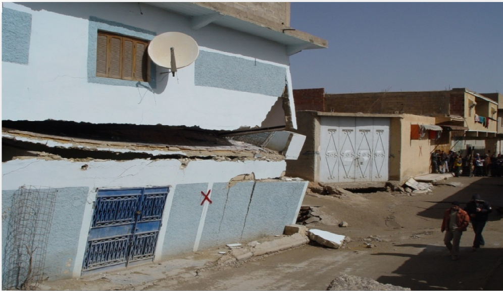
Fig. 55 : Effondrement dans la ville de Chéria et les dommages induits.
