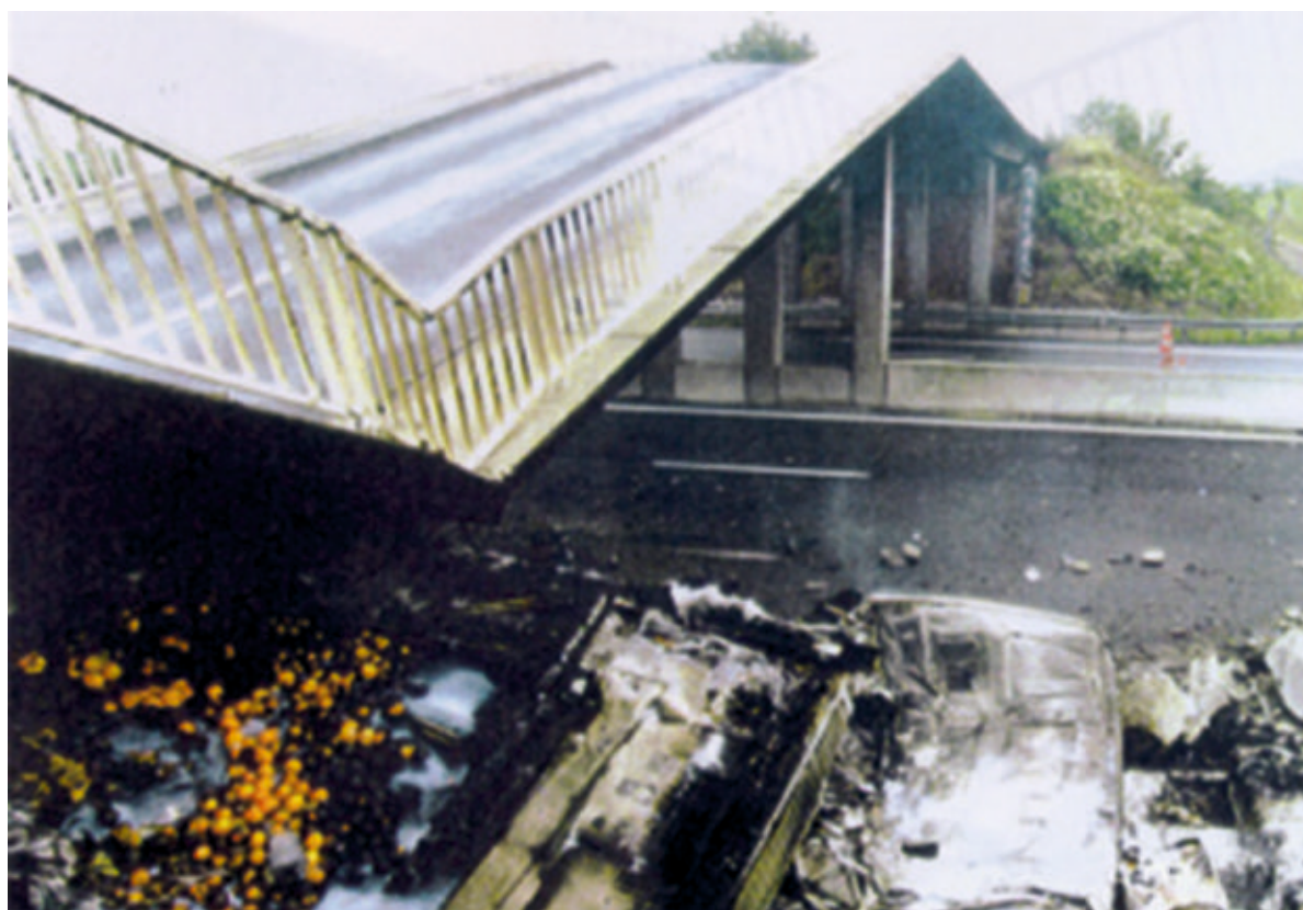
Figure 5 – Choc de véhicule lourd sur une pile de pont ayant entraîné l'effondrement de l'ouvrage (Photo JAC). Depuis cette époque, un renforcement des appuis a été réglementé
