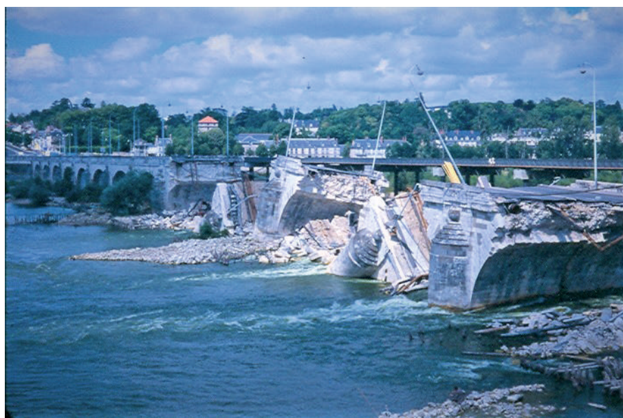
Figure 3 – Exemple d'affouillement au pont Wilson de Tours (photo JAC)
