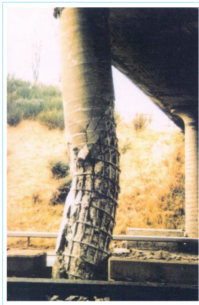
Figure 13 – Choc de poids lourd sur une pile de pont (Photo SIA)
