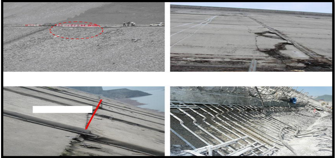
Photo III.13: tassement de la crete et l'endommagement de la face amont et aval du barrage Zipingpu lors du tremblement de terre de Wenchuan Chine (Bin xu, 2014)
