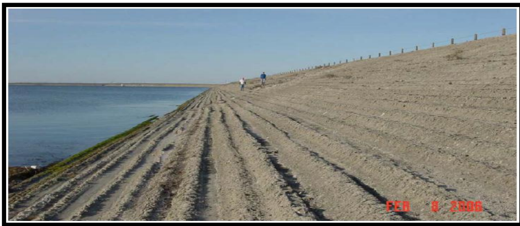
Photo IV.03: protection du talus avec sol-ciment dans le barrage choke canyon, Texas, USA (USBR, 2012)
