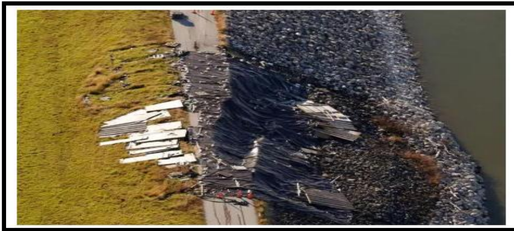
Photo III.02: érosion de la face amont par les vagues (the constructor.org)
