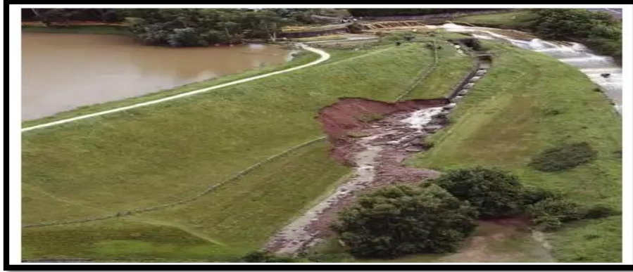
Photo III.03: érosion du pied aval due au débordement de l'évacuateur de crue (The constructor.org)
