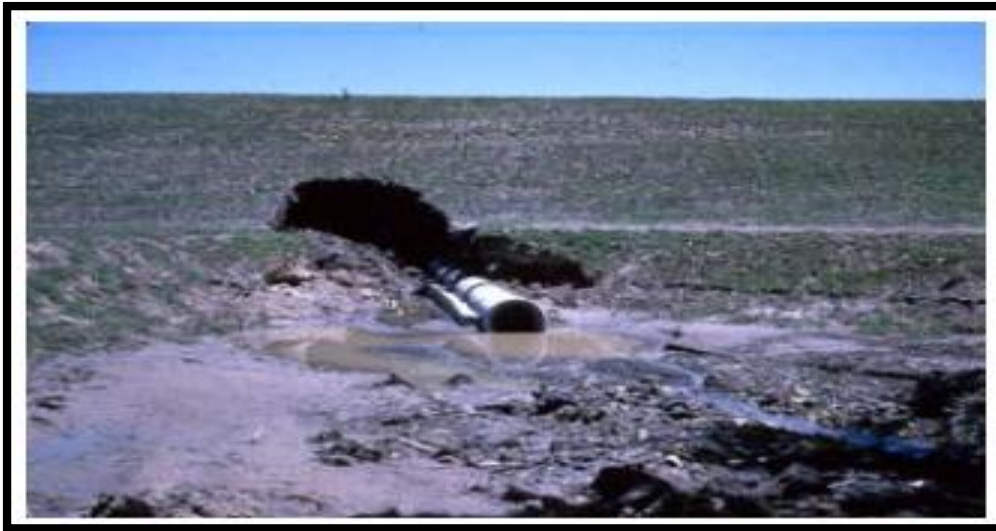
Photo IV.07: rupture d'un barrage à cause d'une conduite sans membrane (USDA, 2016)
