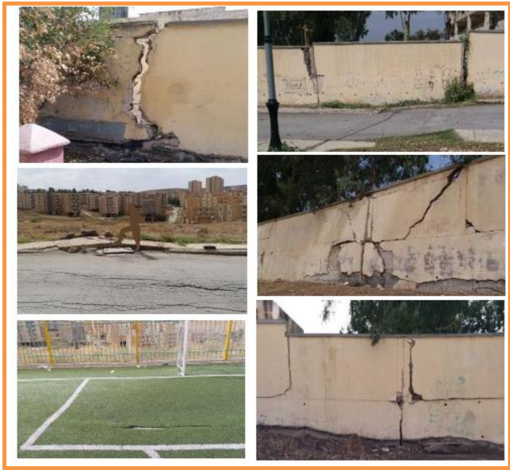
Figure 65 : École endommagée dans le quartier de Boussouf
