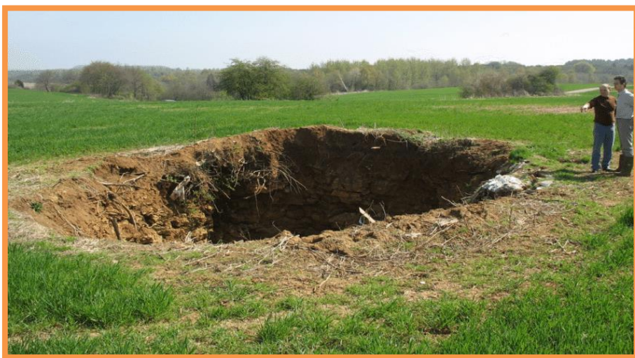
Figure 16 : exemple de l'effondrement de terrain
