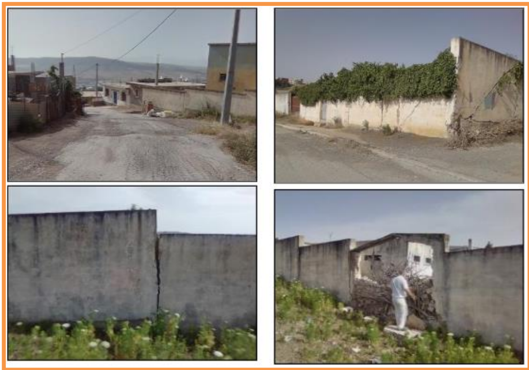
Figure 64 : Dégâts causés par un glissement de terrain sur l'infrastructure à Sidi Arab (sud de Didouche Mourad).
