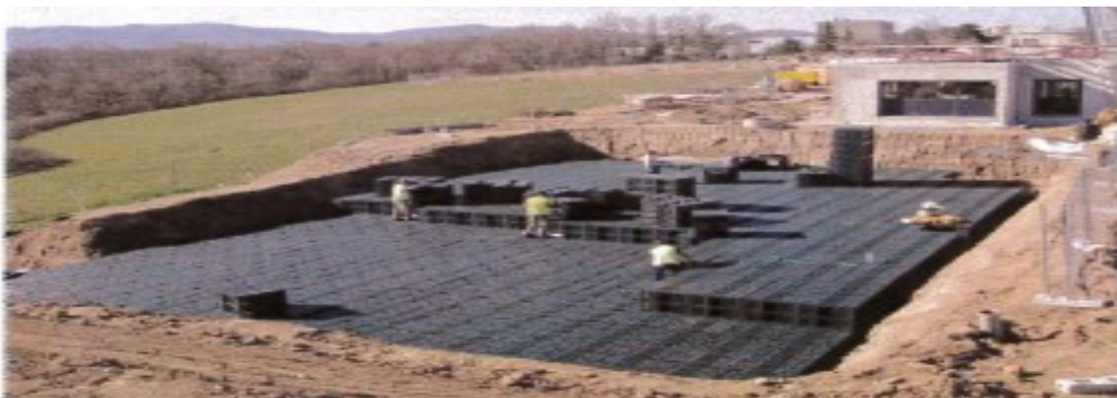
Figure 50 : bassin de rétention enterré
