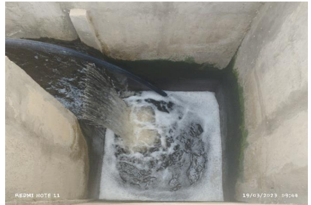
صورة رقم 14: مياه معالجة موجهة للمصب
