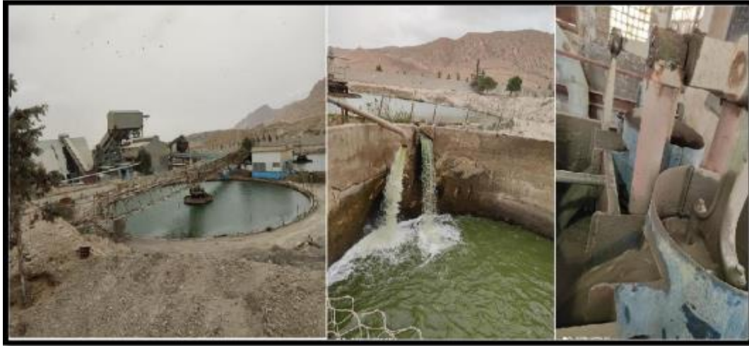
Figure IV. 12: Système de traitement des eaux de lavage de phosphate [32].
