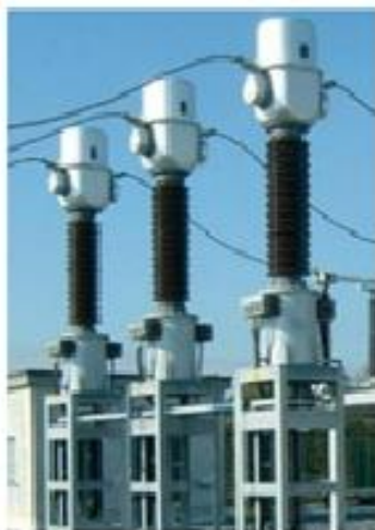
(a) Transformateur de courant
