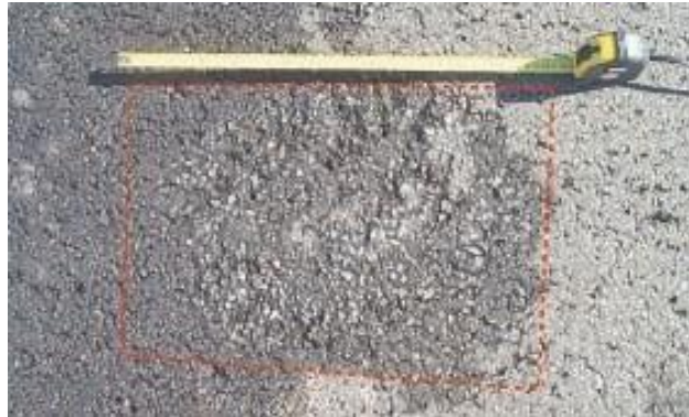
Figure 20 : 2.7.5 Désenrobage (niveau de gravité léger)
