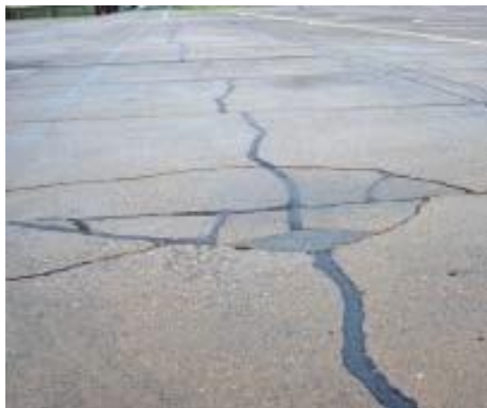
Figure 23 : 2.3.4 fracture avec niveau de gravité élevé
