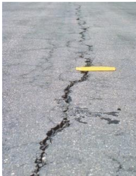
Figure 14 : 2.1.1 Fissure de fatigue (niveau de gravité léger)
