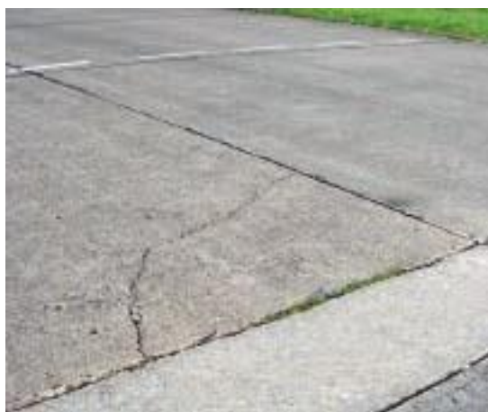
Figure 22 : 2.3.3 fissure en coin avec niveau de gravité léger
