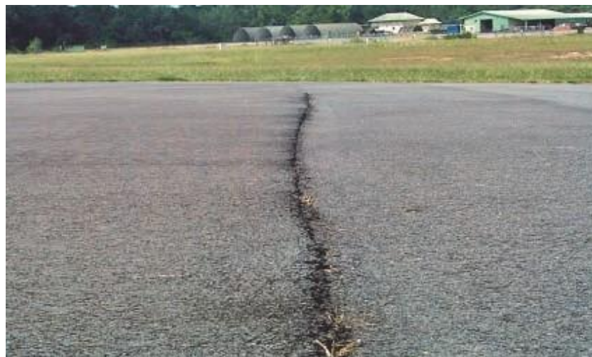
Figure 17 : 2.3.5 Fissure de joint entre deux bandes de répannage (niveau de gravité léger).
