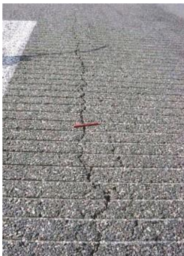
Figure 13: 2.1.1 Fissure de fatigue avec départ de matériaux (niveau de gravité élevé)
