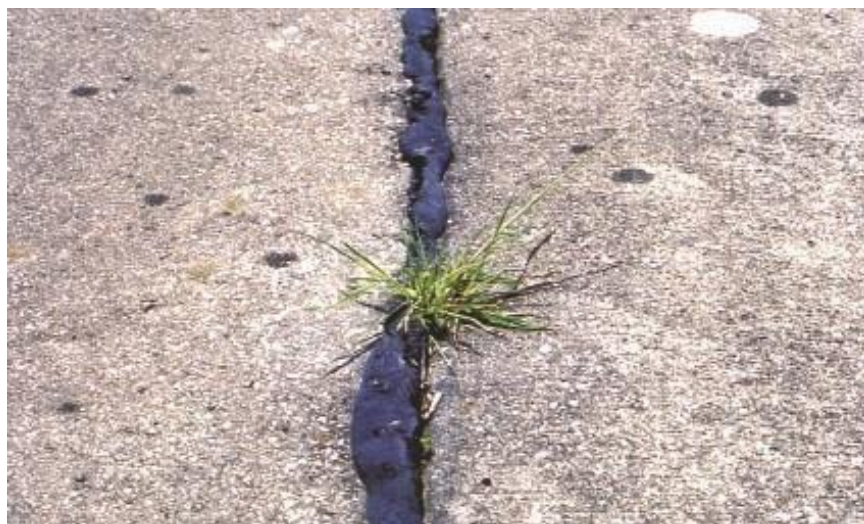
Figure 27 : 2.3.8 Défaut de joint (mauvaise adhérence révélée par la présence de végétation).
