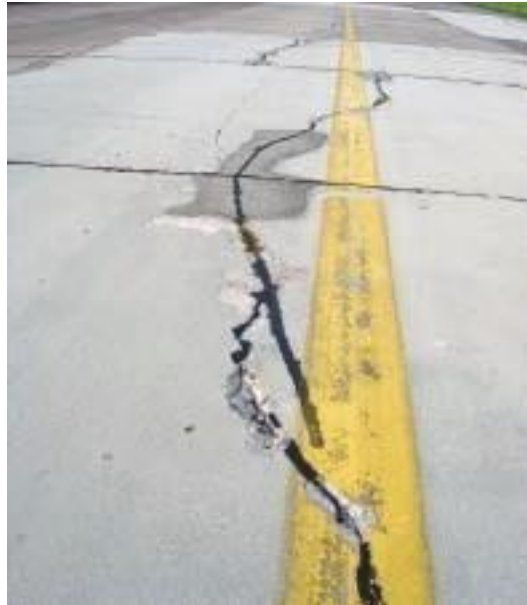
Figure 21: 2.3.2 fissure avec niveau de gravité élevé
