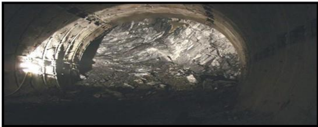
Figure 16 : Le gonflement affecte la route.
