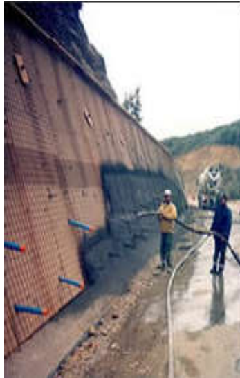
Figure II.5 Boulonnage associé à la mise en place d'un béton projeté jusqu'à 20 cm d'épaisseur.
