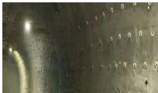
Figure II.4 Boulonnage associé à une faible épaisseur.
