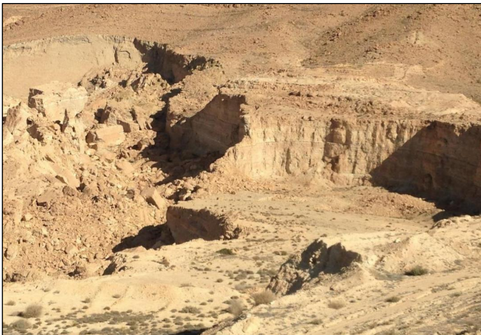
Figure II.9: Glissement de terrain de la zone Sud-Est de Kef Essenoun en 2007 [11]
