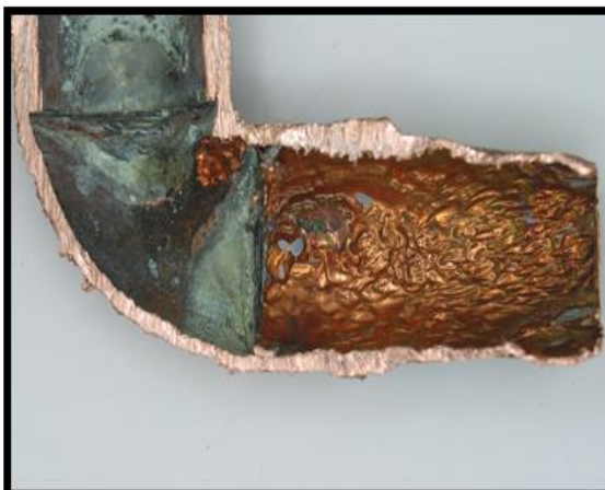
Figure I. 10 : Corrosion-érosion d'un tube de transport d'eau en cuivre.
