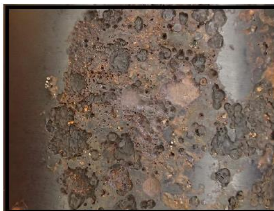
Figure I. 7 : Piqûre de corrosion d'une pipe en acier.
