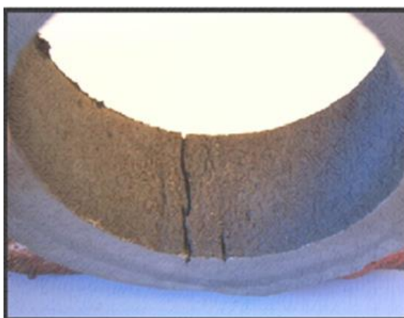
Figure I. 13 : Rupture due à la corrosion par fatigue d'un tube d'économiseur à basse pression [59].
