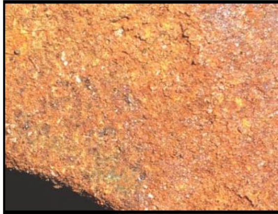
Figure I. 5 : Corrosion uniforme d'un acier.
