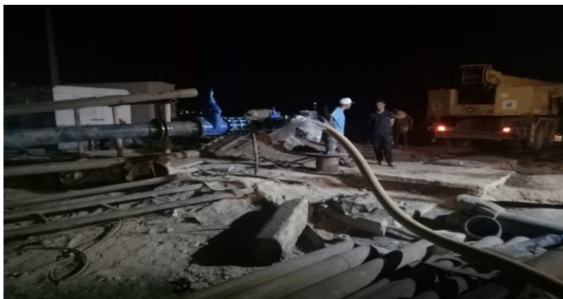
Fig. 54 d : Équipement du forage P2 par les services l'ADE.
