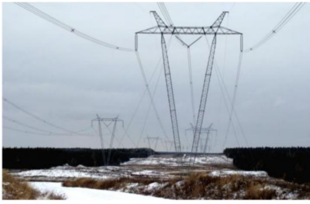
Pylône électrique haubané en V
