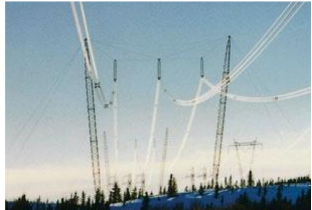
Pylône électrique à chaînette
