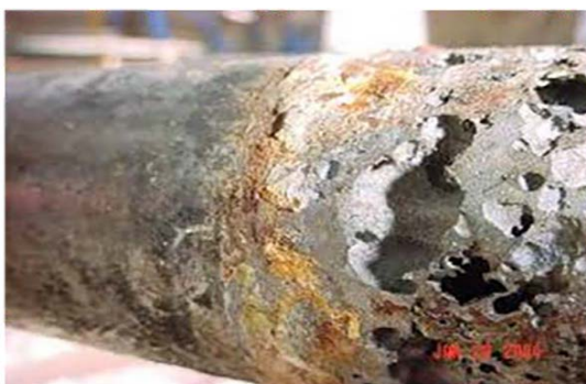
Figure I.3 : Corrosion par piqûres
