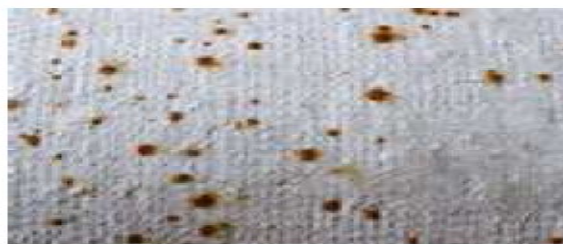
Figure [1.4] : corrosion par piquêre
