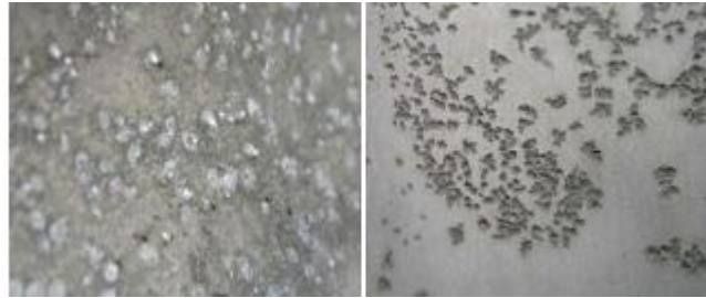
Figure- I. 2 Corrosion par piqûre
