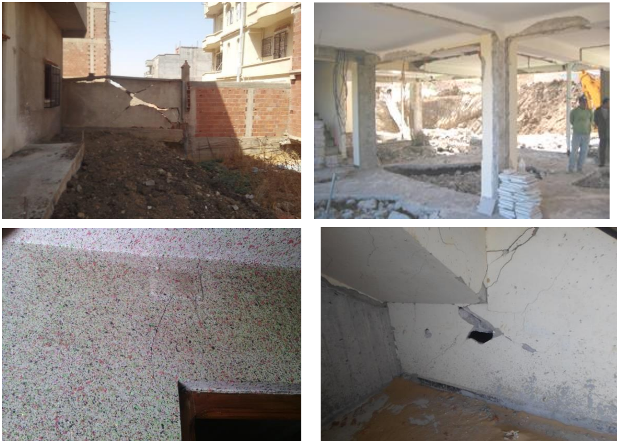
Fig.62 : Désordre des constructions installées dans la région de Mila.
