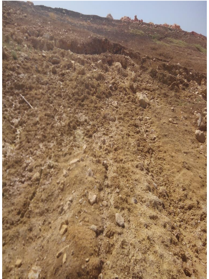
B : La nappe à la surface génère un glissement
