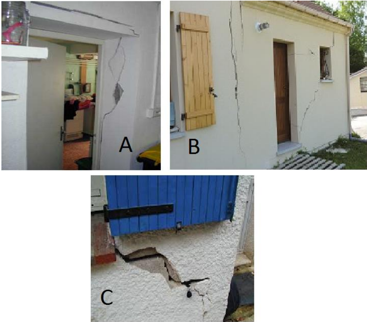
Figure 01 : Photos (a, b, c) montrant le risque et conséquences Du phénomène sur les structures (BRGM)
