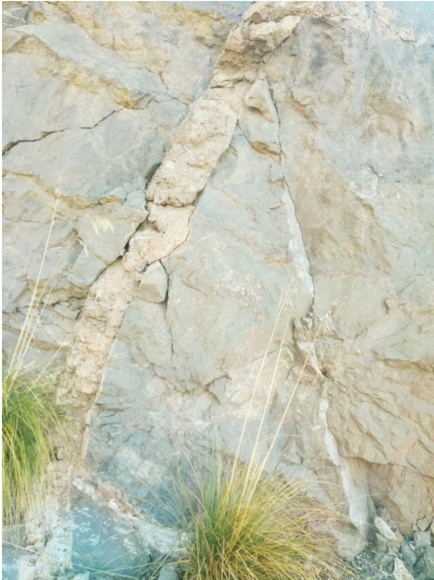
Figure 25 Joint fermé à droite et un autre largement ouvert et rempli à droite
