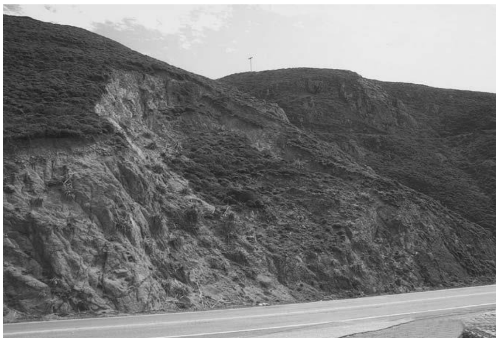
Figure 15: Rupture circulaire dans une roche granitique fortement altérée (Duncun 2008, autoroute en Californie).
