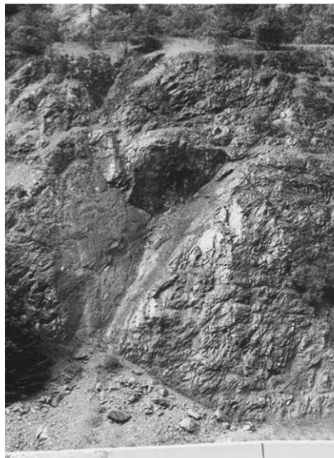
Figure 12: Rupture de coin typique impliquant un glissement sur deux joints persistants avec une ligne d'intersection coupant le talus au pied de la paroi rocheuse et un plan supérieur qui forme une surface de relâchement.
