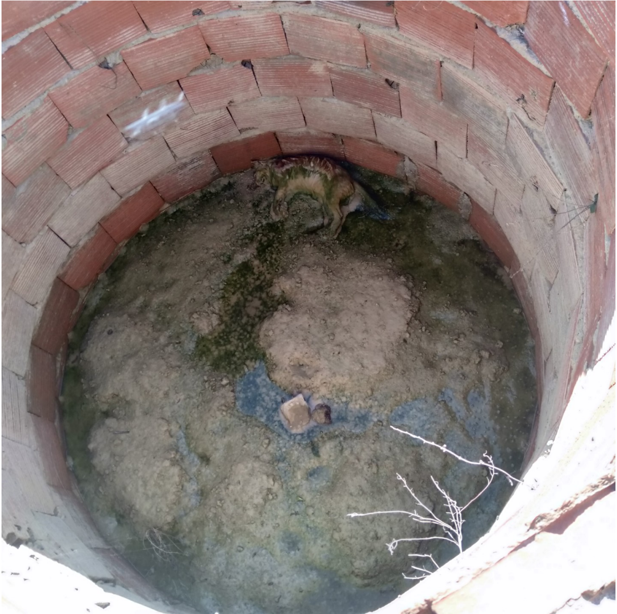
Les conséquences du manque de protection des puits
