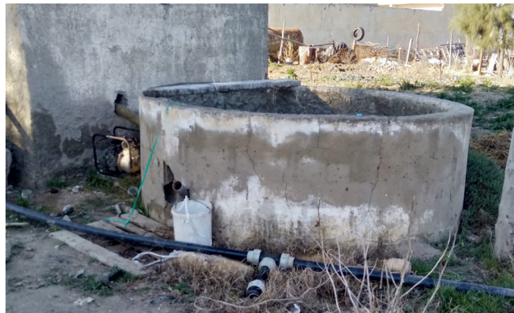
Puits domestique pollué a profondeur de 4m.
