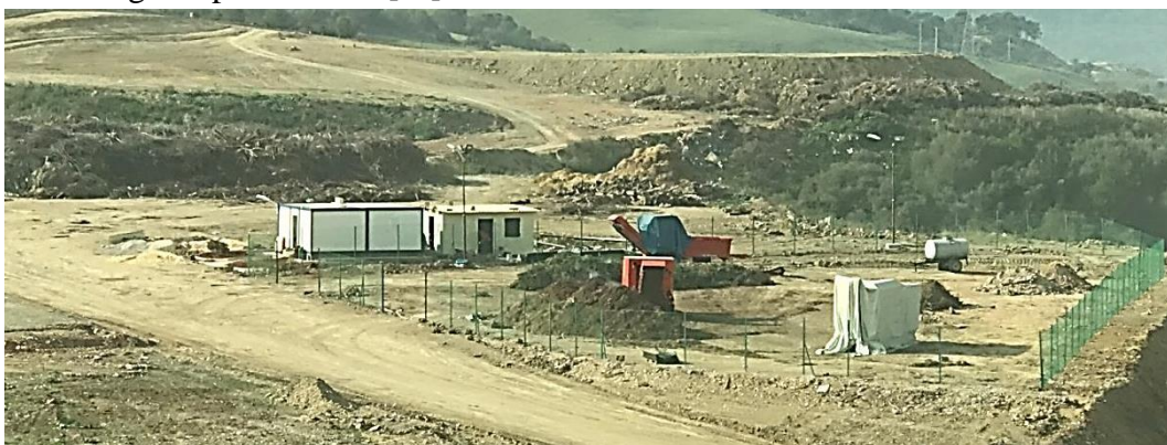
Figure III.30 : station du compostage des déchets verts
