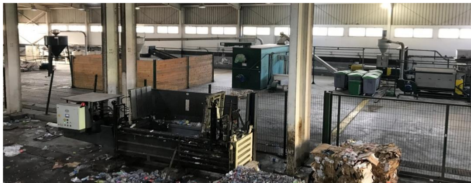
Figure III.24 : station de transformation des sachets plastiques
