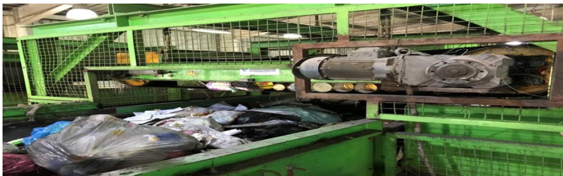
Figure III.21 : convoyeur magnétique ( séparation des métaux fereux )
