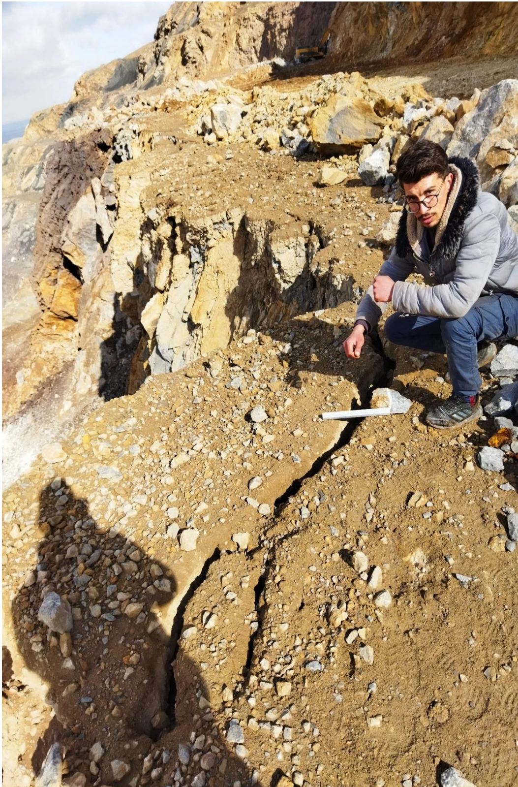
Figure III.6 Front épaufré en bande d'escalier.
