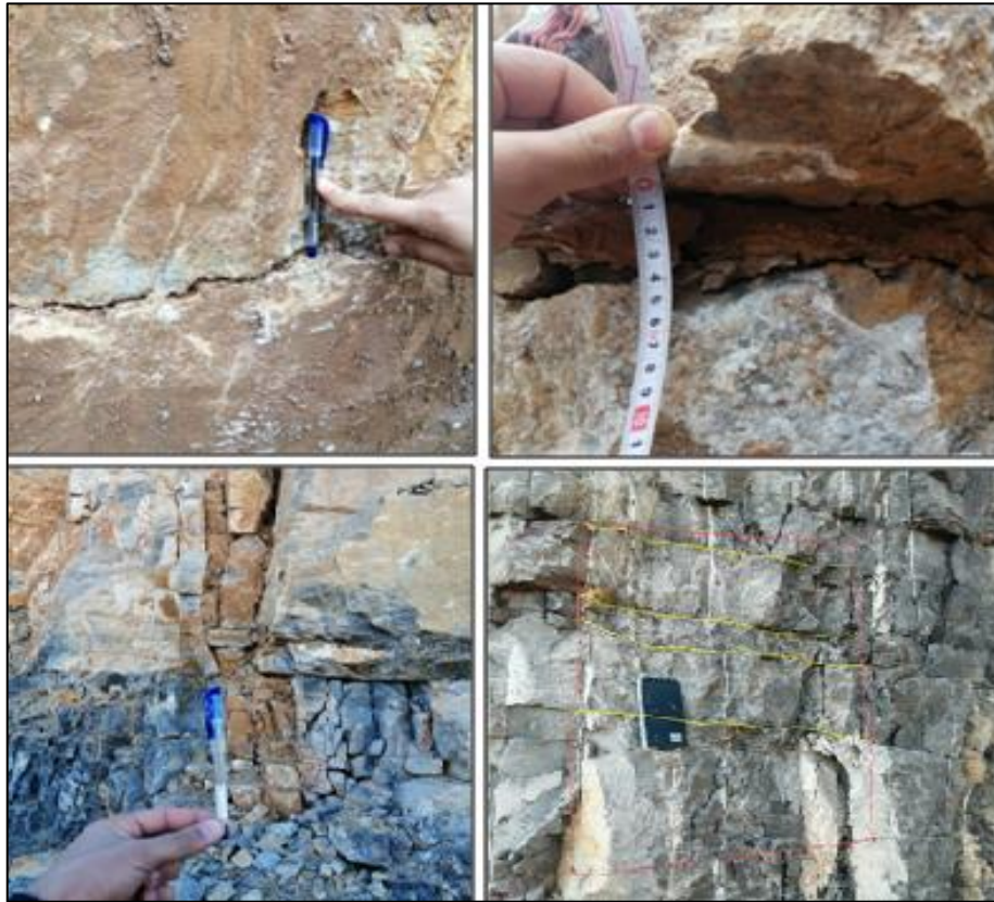
Figure V.1. Nature des fissures et des joints
