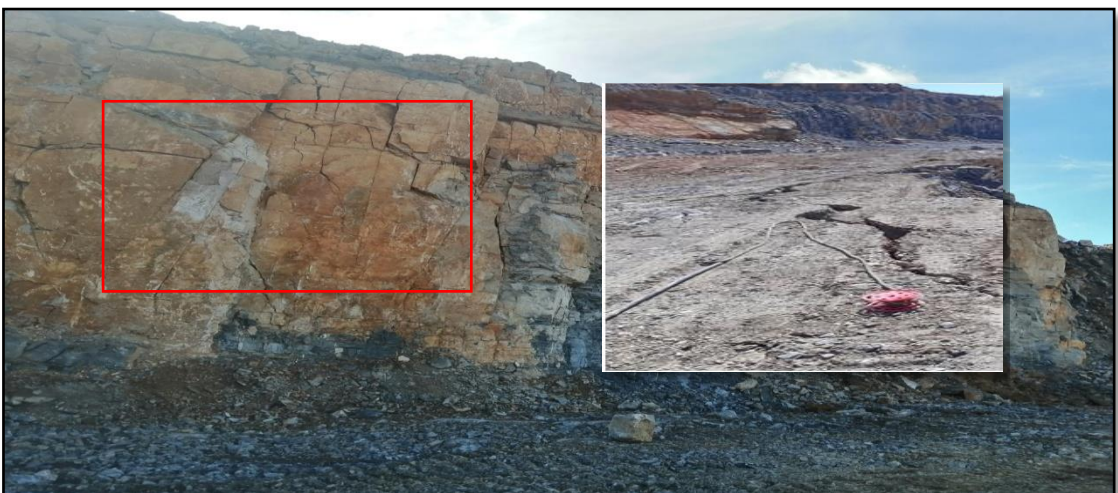
Figure V.8. Effet arrière di tir (fissuration de front)
