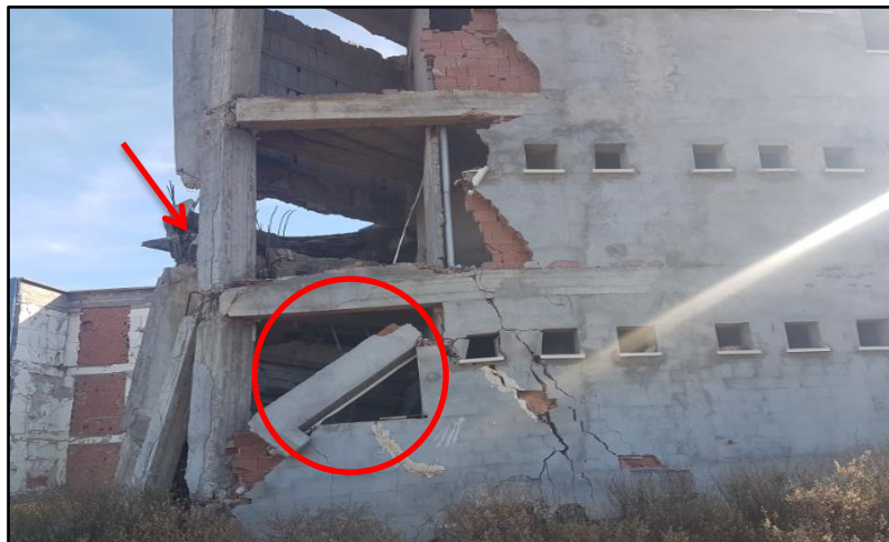
Figure II.33. Cassure de la poutre.
