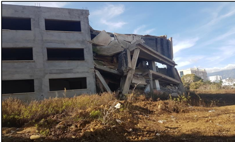
Figure II.31. Dégradation de bâtiment.
