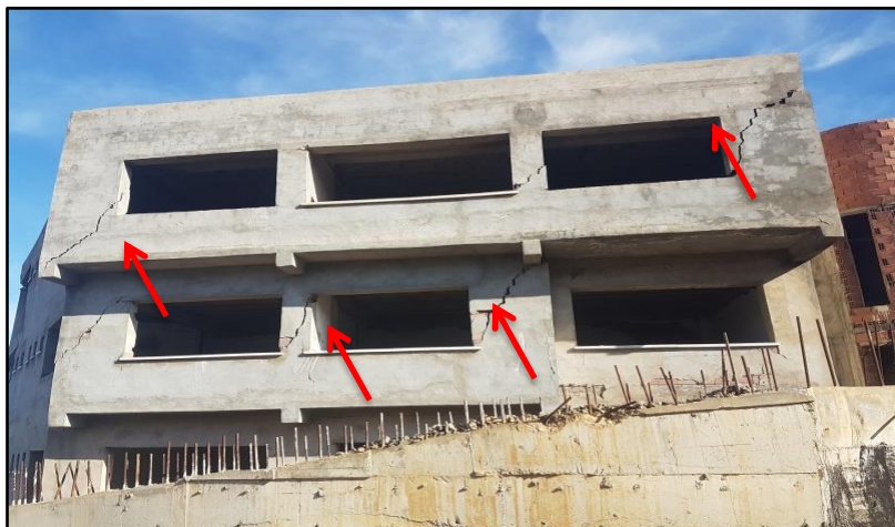
Figure II.32. Les fissures de traction dans la structure.
