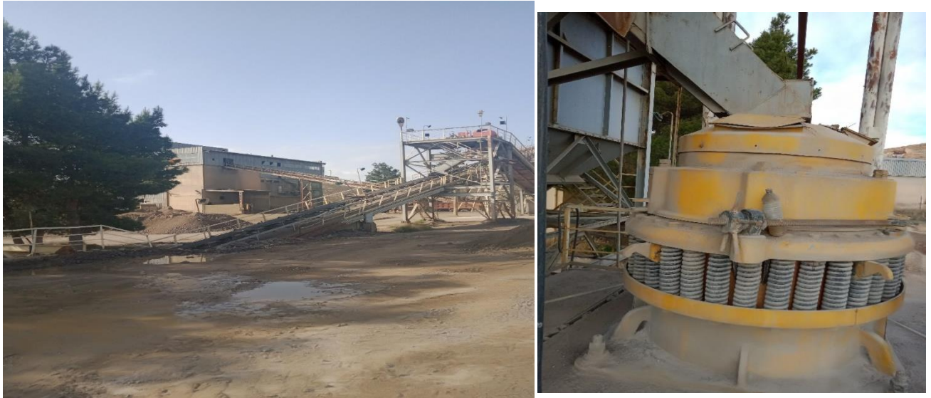
Figure I.11 : Vue de la section de concassage et criblage de l'usine de Kherzet Youcef, 2021
