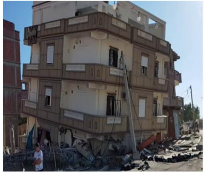
Figure 52 :Affaissement d'une maison suite à un défaut de portance due à la liquifaction
