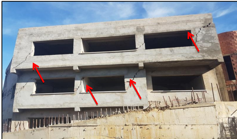
Figure II.32. Les fissures de traction dans la structure.
