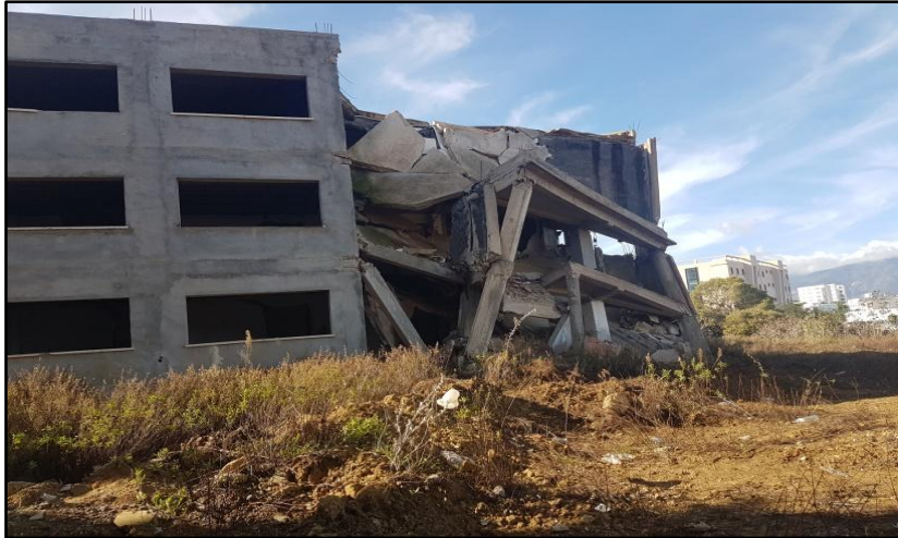
Figure II.31. Dégradation de bâtiment.
