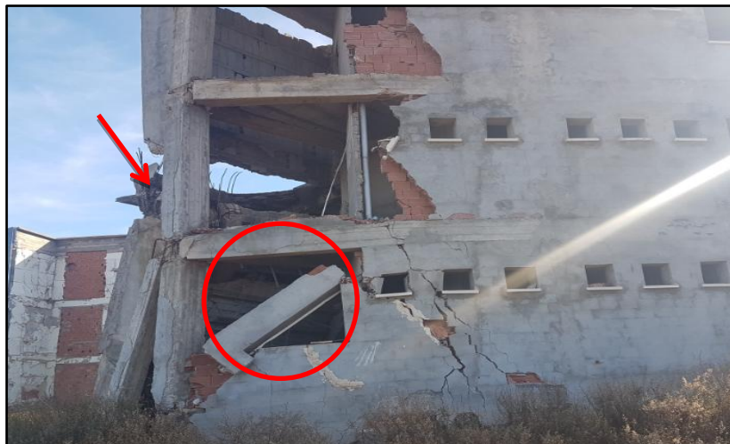
Figure II.33. Cassure de la poutre.
