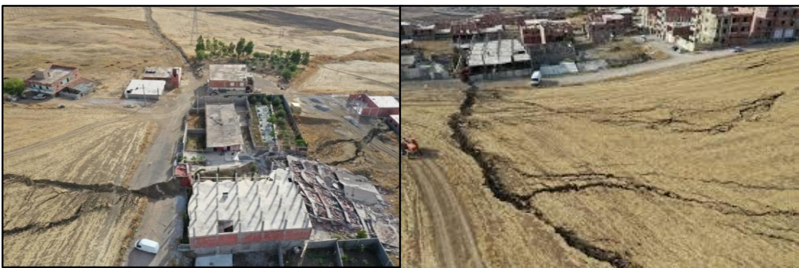
Figure I.10. Glissement de Mila (7 Août 2020). [19]
