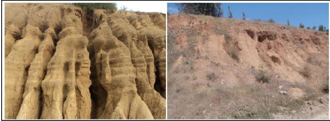
Figure I.15. Exemple de talus de déblai dans des sols de la matrice meuble érodés – CW Boukerdane TIPAZA. [23]
