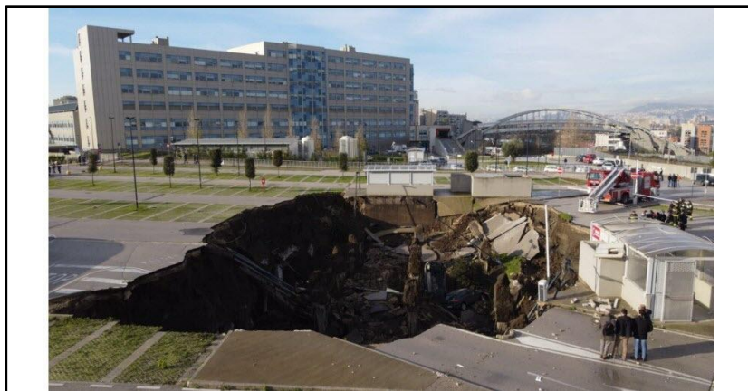
Figure I.12. Effondrement de terrain à Naples (8 janvier 2021). [21]
