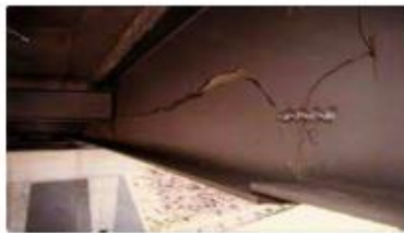
Figure 5. Fissuration d'un pont
