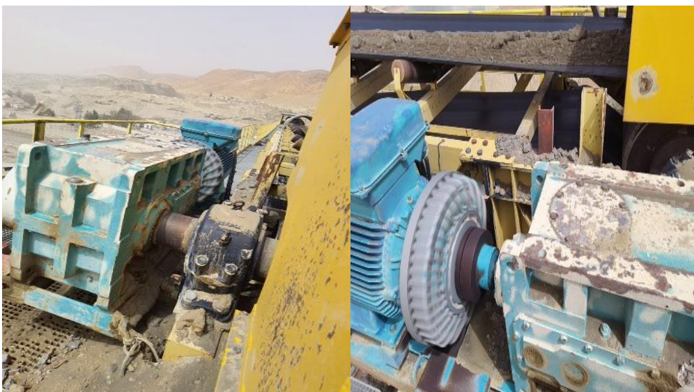
Figure 4.6 : Photo du système étudié (entreprise somiphos)
