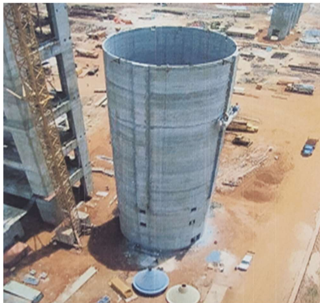
Figure I.10. Silo de stockage et homogénéisation.
