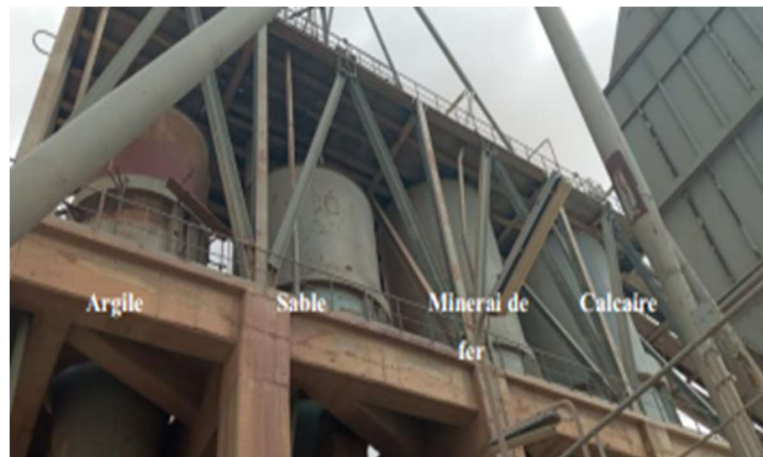
Figure II.15. Les trémies de dosage, cimenterie d'Elma Labiod – Tébessa.
