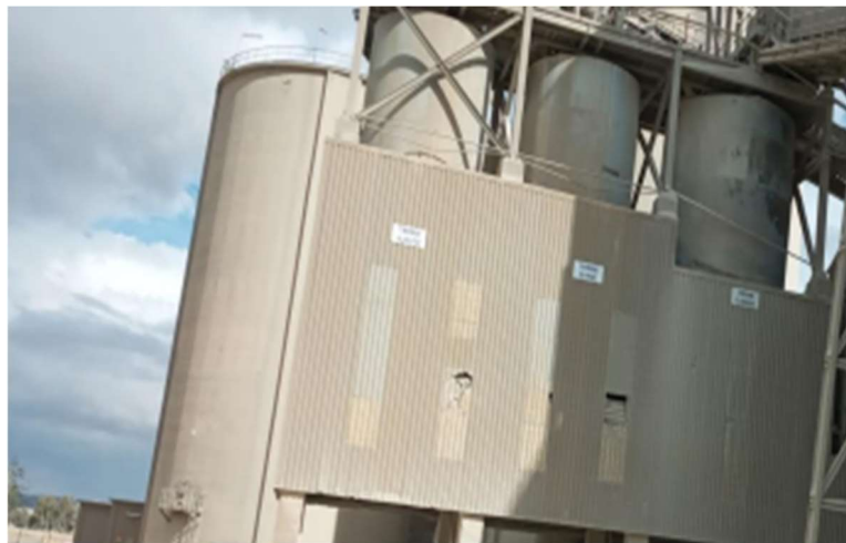
Figure II.27. Trémie de dosage (clinker, gypse et ajouts).
