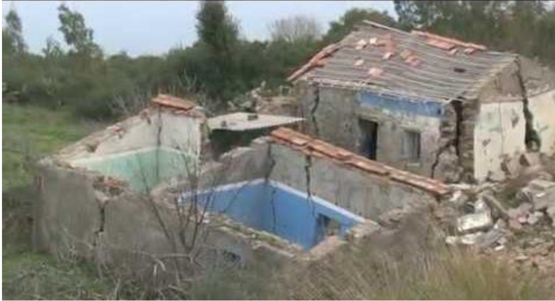
الشكل 13: من بين الآثار غير المرغوب فيها لأعمال التفجير تكسير وتشقق المباني المجاورة
