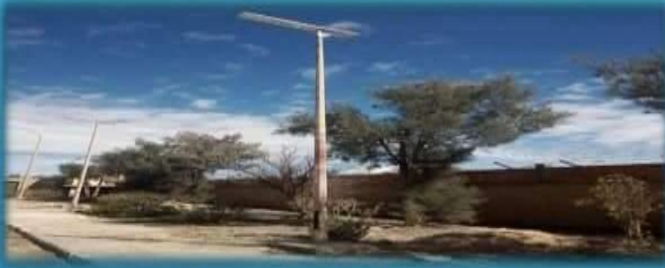
Panneaux solaires à LED
