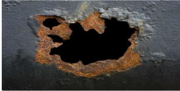
Figure I.4: Corrosion par piqûre dans les tuyaux en acier doux.
