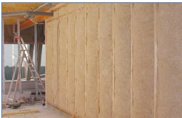
Photo n° 31: Mise en place du chanvre. Source : Guide de l'éco-construction, Agence régionale de l'environnement en Lorraine. [ADEME]. page: 21.
